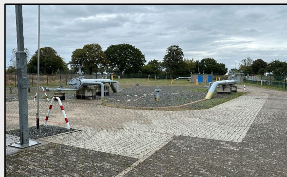
Abb.: Typische Rohrenden zum Anschluss mobiler Molchschleusen
