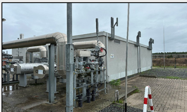
Abb.: Beispiel einer Messtation in Stahlbeton-Containerbauweise
